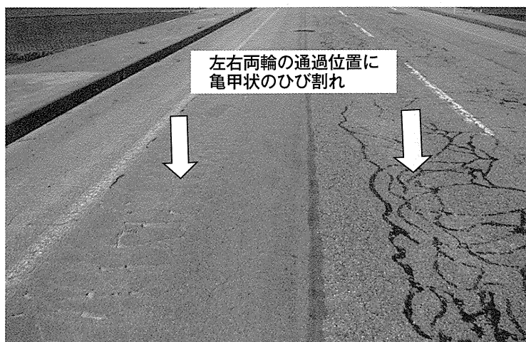
写真-1 アスファルト舗装の破損状況 (200 m 以上にわたり連続した破損)
