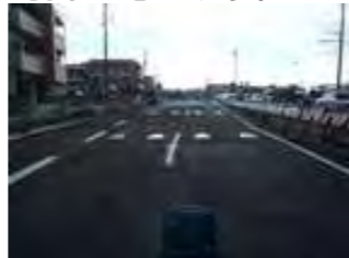
中央部に約1mの段差
