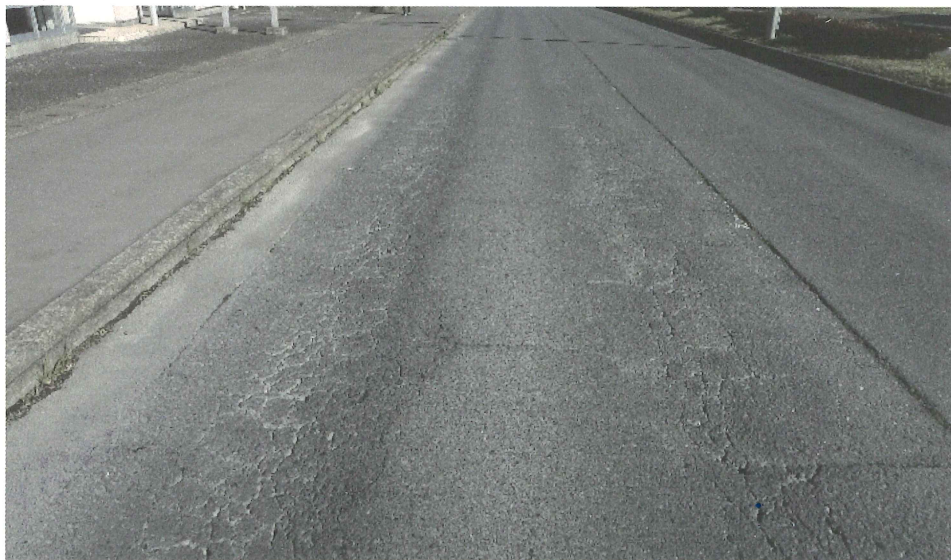
写真 3-1 ひび割れの状況
