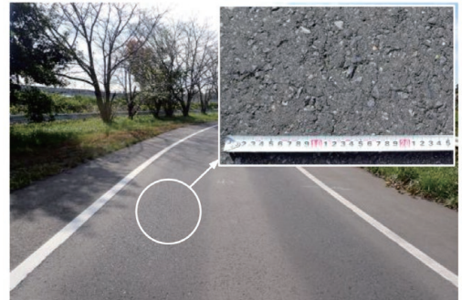
写真－７ ひび割れの発生状況(50万輪走行後)
